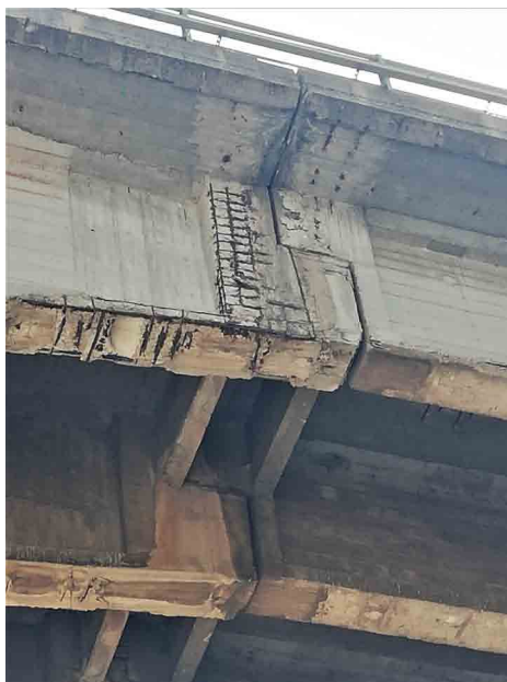
Segni di degrado del ponte
